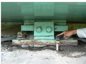
沓座モルタル損傷状況
