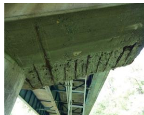
かぶりコンクリートの剥落状況
