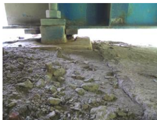
橋脚上面劣化状況
